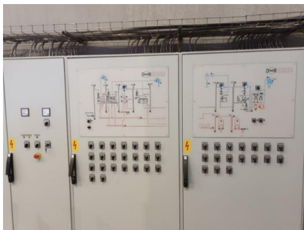
Slika 7. Glavna električna ploča
