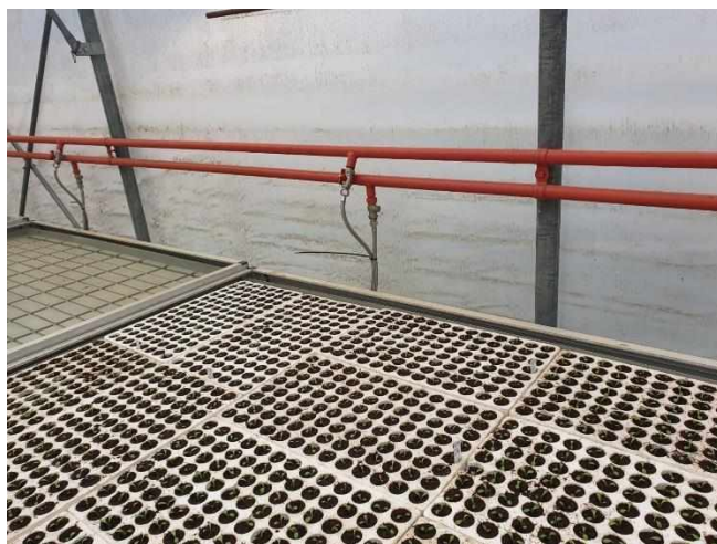
Slika 2. Cijevi s toplom vodom
