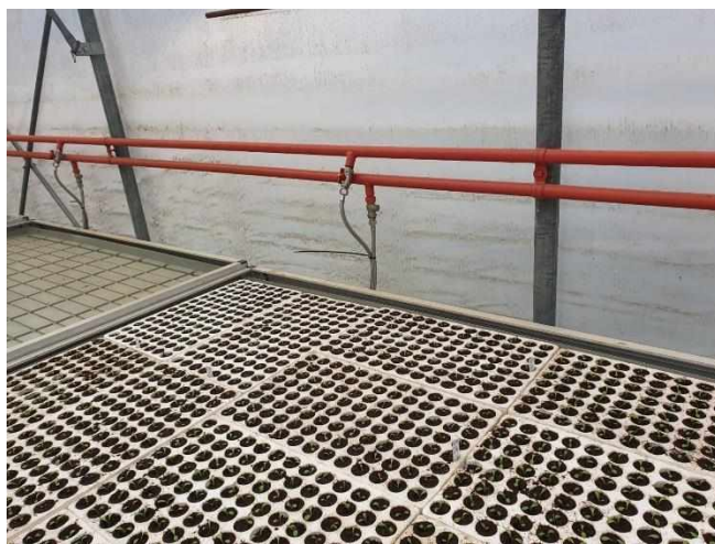
Slika 2. Cijevi s toplom vodom
