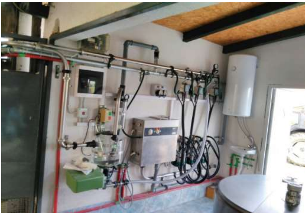
Slika 19. Sistem mljekovoda i izmuzište Westfalia
