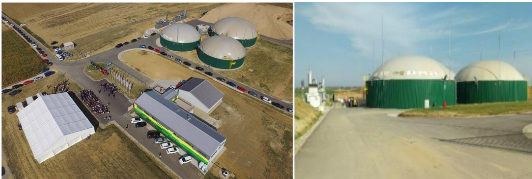
Slika 13. i 14. Pogled na bioplinско postrojenje
