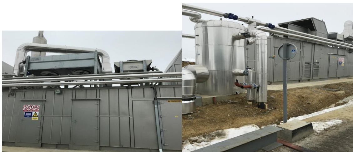
Slika 20. i 21. Kontejnerska kogeneracijska jedinica
