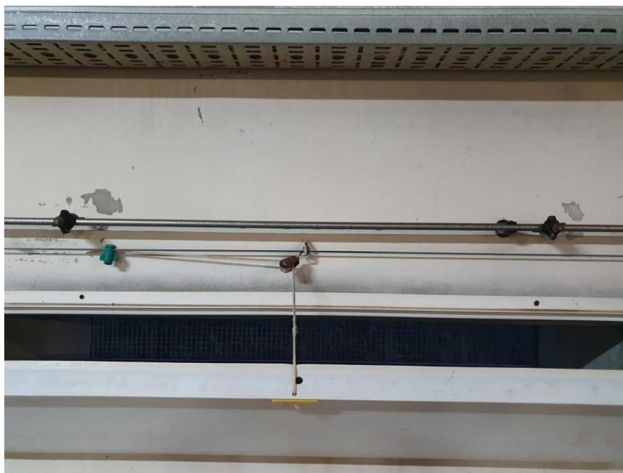
Slika 1. Rashladni sustav na farmi
