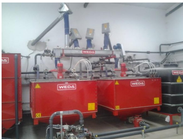
Slika 13. Rezervoar s mješačem
