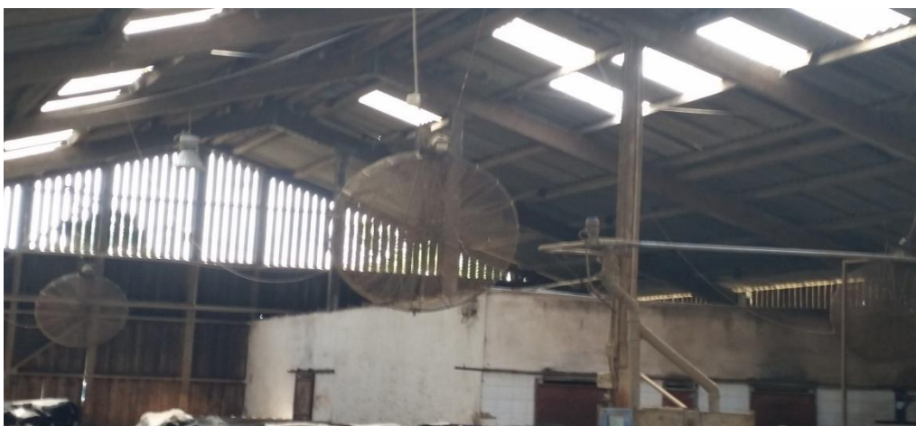
Slika 11. Ventilatori na OPG – u
