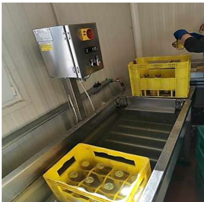
Slika 13. Spremnik s vodom za hlađenje sokova
