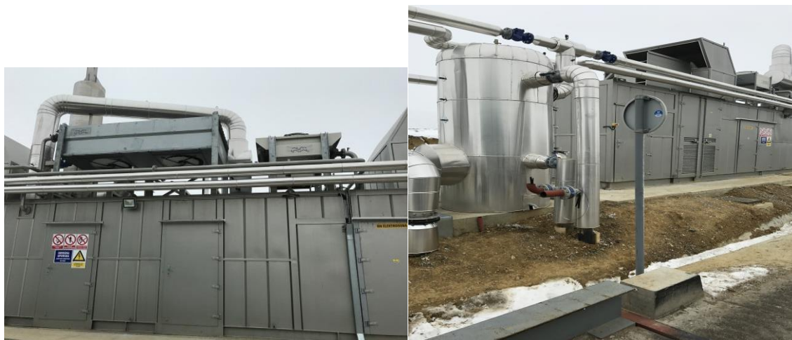
Slika 20. i 21. Kontejnerska kogeneracijska jedinica
