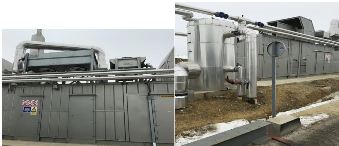
Slika 20. i 21. Kontejnerska kogeneracijska jedinica
