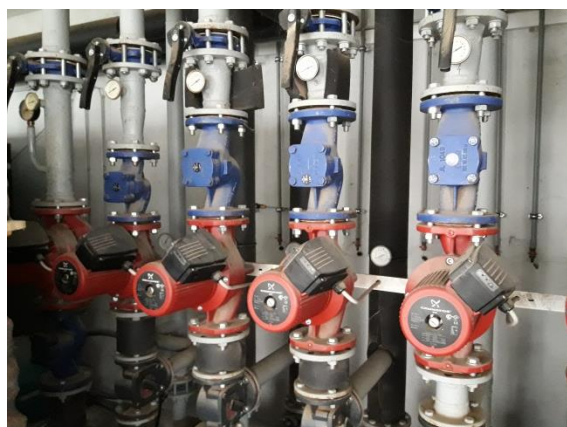
Slika 25. Pumpe za vodu
