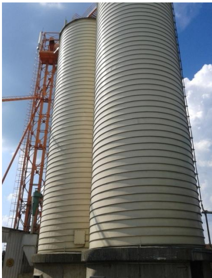
Slika 10. Silosi kapaciteta po 500 t
