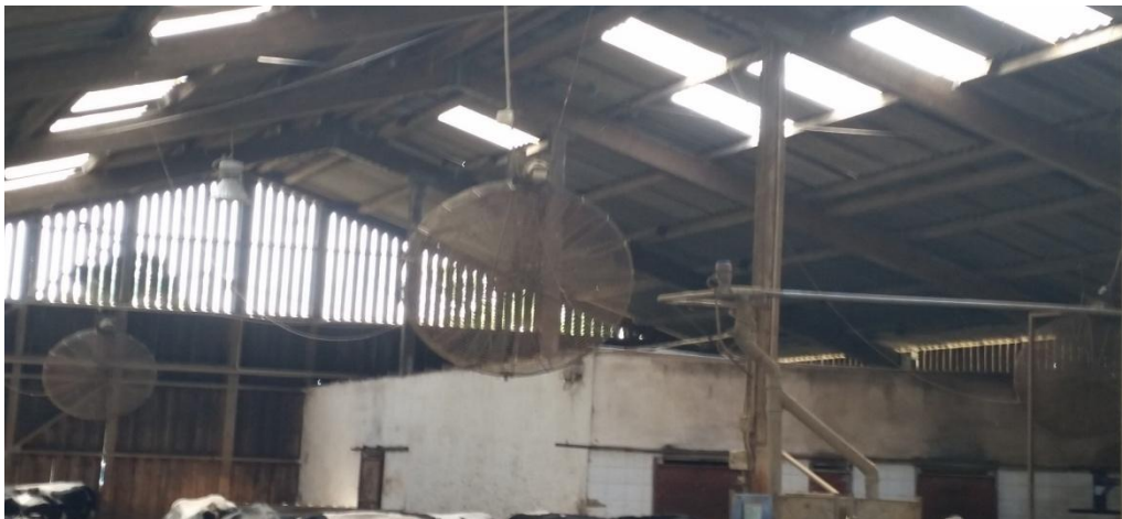
Slika 11. Ventilatori na OPG – u
