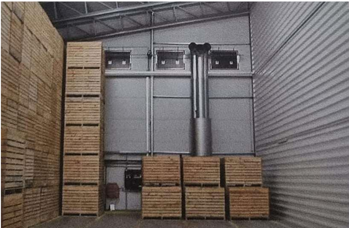
Slika 19. Komora za skladištenje s jedinicom za prozračivanje i hlađenje
