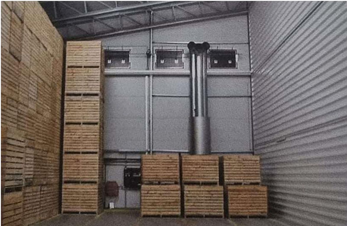
Slika 19. Komora za skladištenje s jedinicom za prozračivanje i hlađenje
